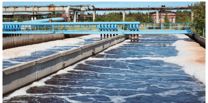
Hệ thống xử lý nước
